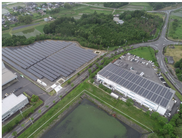
【太陽光発電システム竣工写真】 2,284kw
