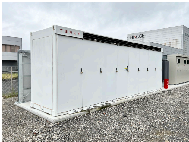
【Megapack竣工写真】 3,049kWh
